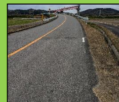
修繕が待たれる町道
