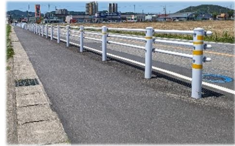
境界ブロック除去と歩道凹凸修繕も同時に実施した通学路
